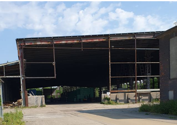
Reste einer Lagerhalle auf dem WASAG-Gelände.
